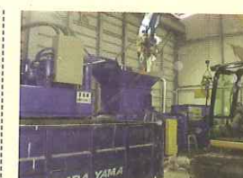
硬質プラスチック等を圧縮する圧縮機
